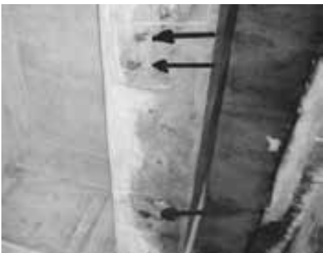
長寿命化の補修が待たれる村内の橋 (橋を下から撮影 矢印の箇所ひびが入り鉄筋の錆が出ている、橋の桁)
