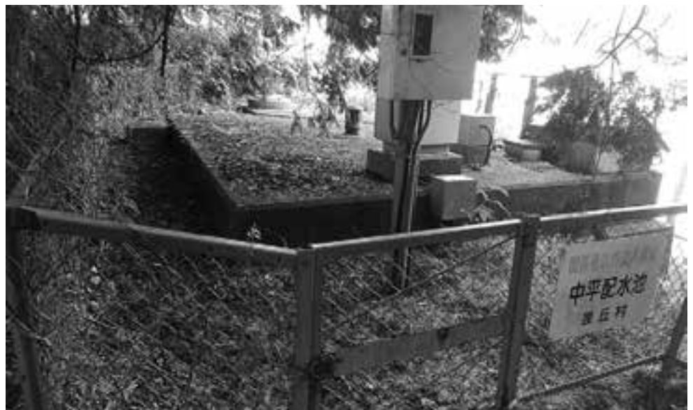
村の水道水の多くは地下水を各配水池へ一旦ポンプアップし各家庭へ
