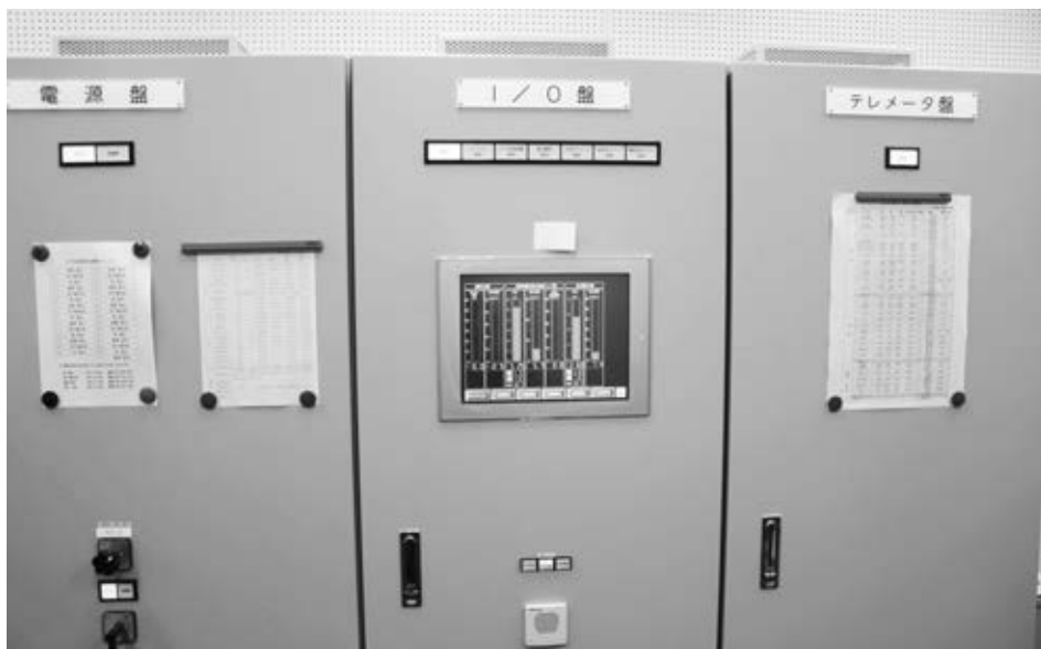
豊丘村上水道事業へ移管する、給水監視装置
