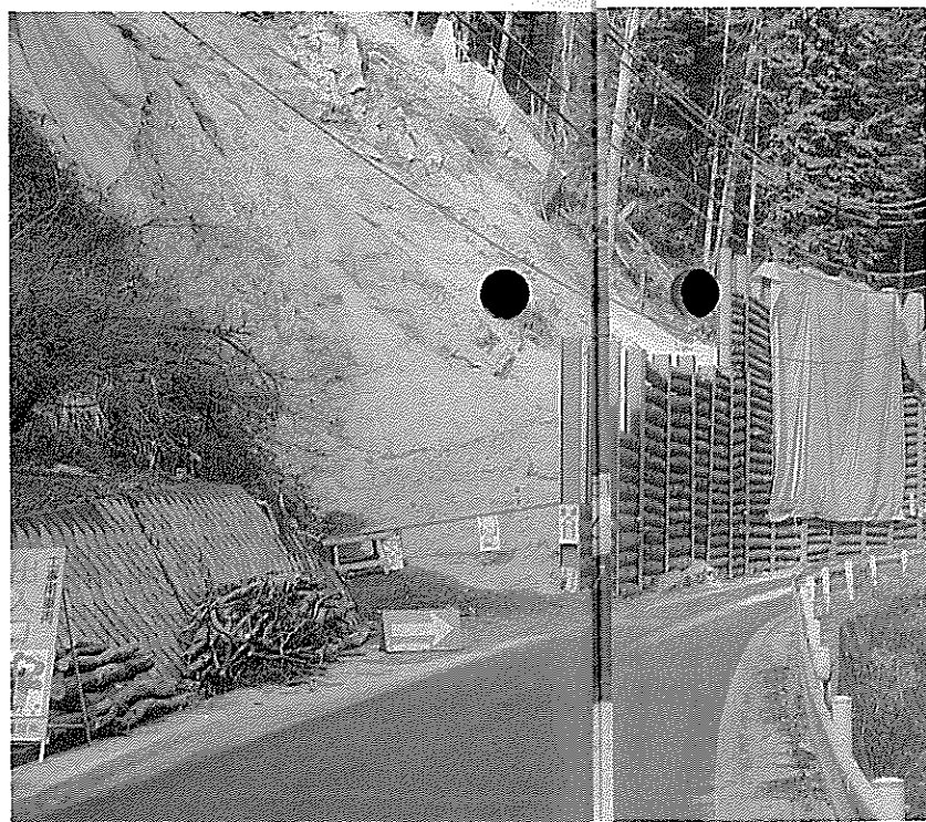
復旧待つ長沢線の崩落現場
