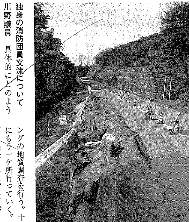
広域農道 喬木村境の災害現場
