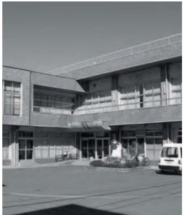
老朽化の進む福祉センター
