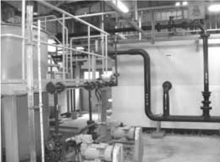
林里の下水道処理場内部
