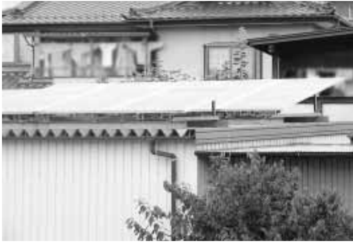
車庫の屋根に設置されたソーラーパネル
