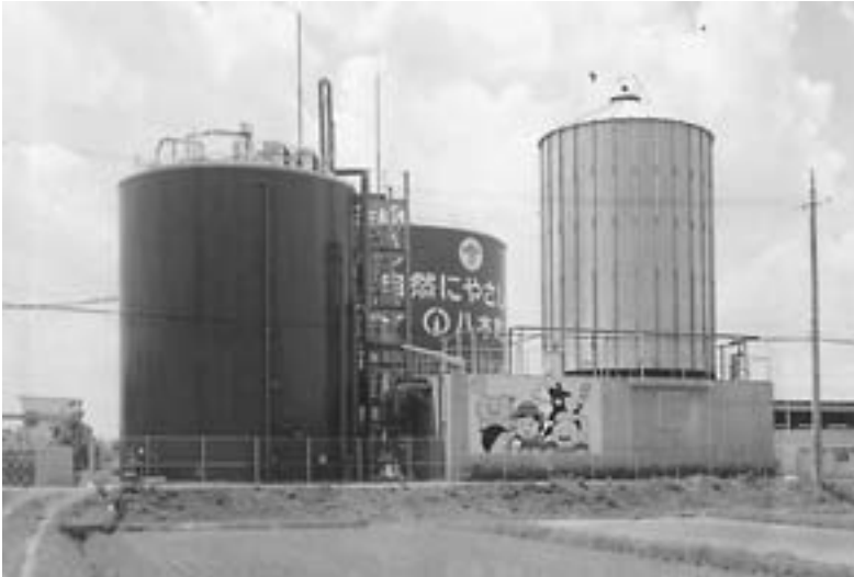
バイオガス貯蔵タンク
