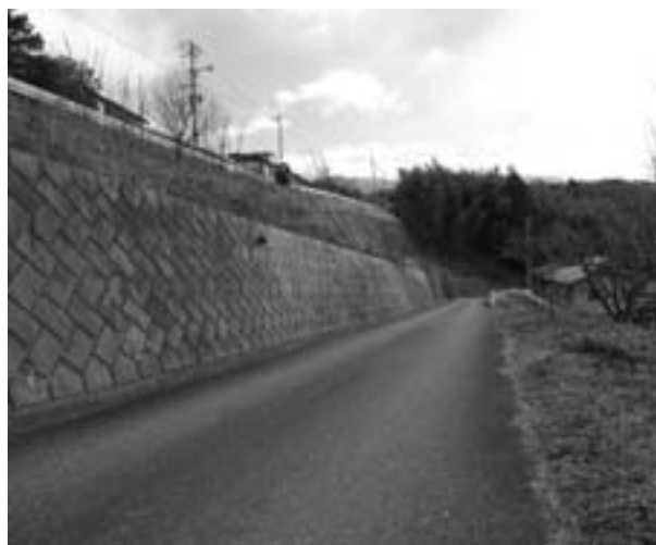
倒壊不安のブロック積
