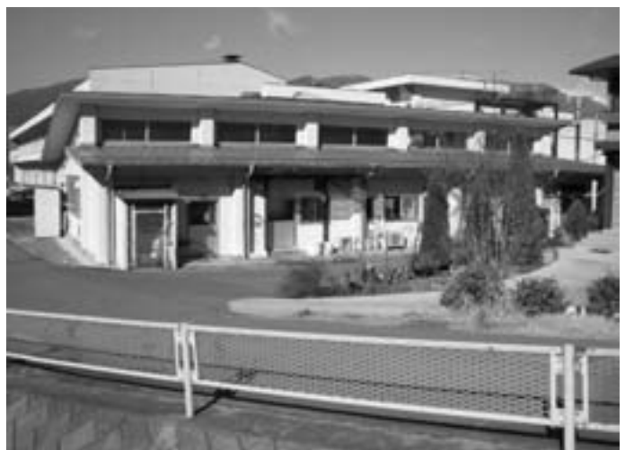
老朽化が進む給食センター
