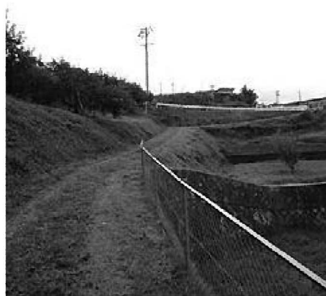
道路改良が望まれる村道ビヤ沢線
