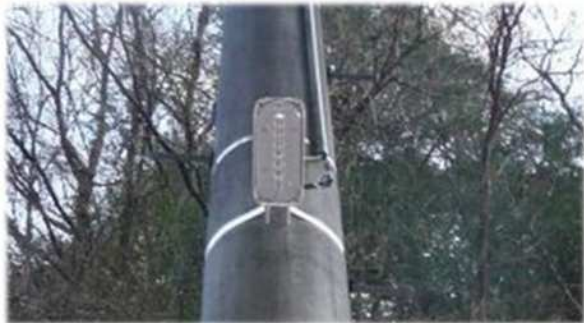
LED化された防犯灯
